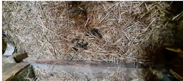
Abb. 16: Im Dachboden von Gebäude 1 befand sich Stroh und Heu mit Kotspuren von Steinmardern
