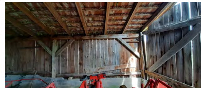
Abb. 24: Innenansicht der Wände und Decken von Gebäude 3.
