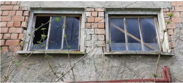
Abb. 19: Offene Fenster und spaltenreiches Mauerwerk von Gebäude 2
