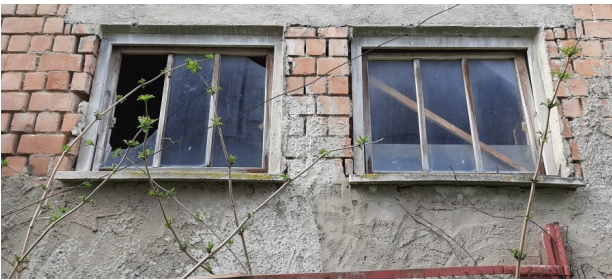
Abb. 19: Offene Fenster und spaltenreiches Mauerwerk von Gebäude 2
