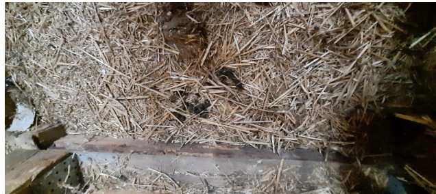
Abb. 16: Im Dachboden von Gebäude 1 befand sich Stroh und Heu mit Kotspuren von Steinmardern
